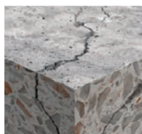
Бетон с трещинами
