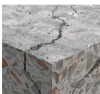
Бетон с трещинами
